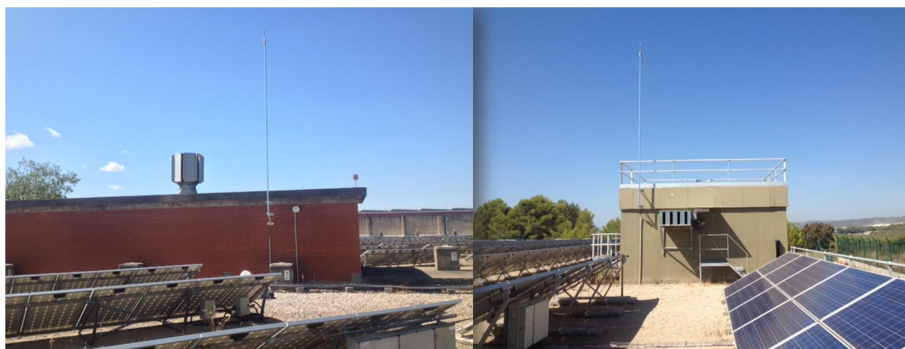
Vista general de pararrayos junto a placas solares en las ETAPs
